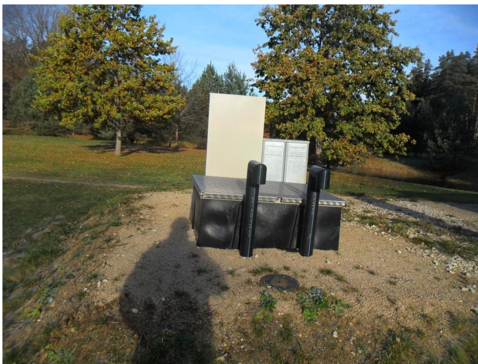
Joonis 5-11 Tõrva reovee peapumpla – Õhne pumpla välisvaade
