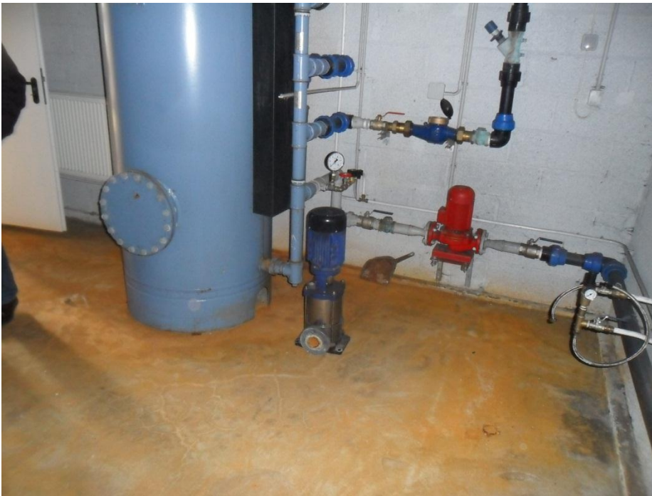
Joonis 5-2 Riiska pumpla sisevaade, survefilter ja uhteveepump
