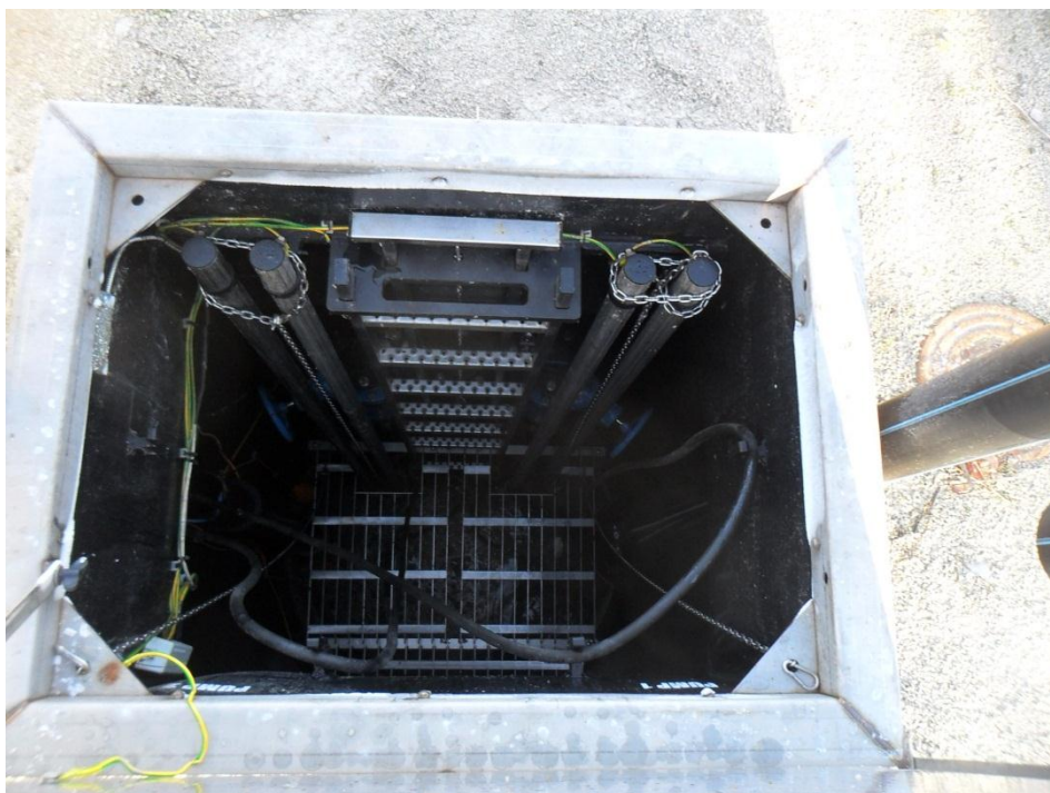
Joonis 5-9 Riiska reoveepumpla sisevaade (näha 2*2 pumba juhtvardad, redel ja teenindusplatvorm)
