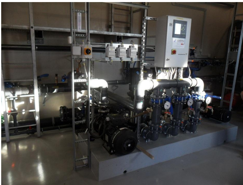
Joonis 5-7 II-astme pumpla, vasakul tuletõrjevveepump, keskel kolm võrgu rõhutõstepumpa, paremal uhteveepump
