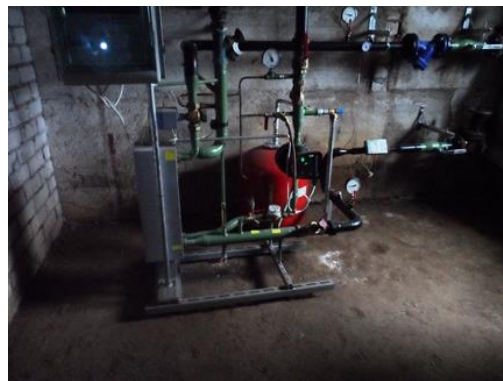
b) Soojusvahetiga soojussõlm
