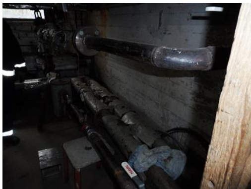
a) Otseühendusega soojussõlm
