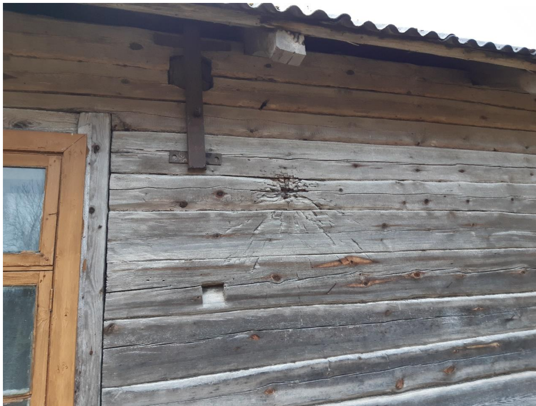
Joonis 3. Tänini säilinud sõjakahjustused Kiisa-Risti taluhäärberi välisseinal.
